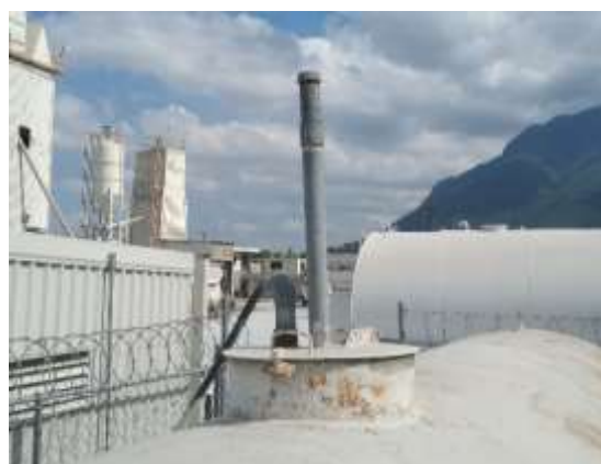
Tubo Sonda en tanque (sin modificar)
